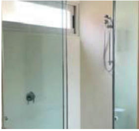
Cristal templado 9mm en regaderas | 9mm tempered glass in shower cabins
